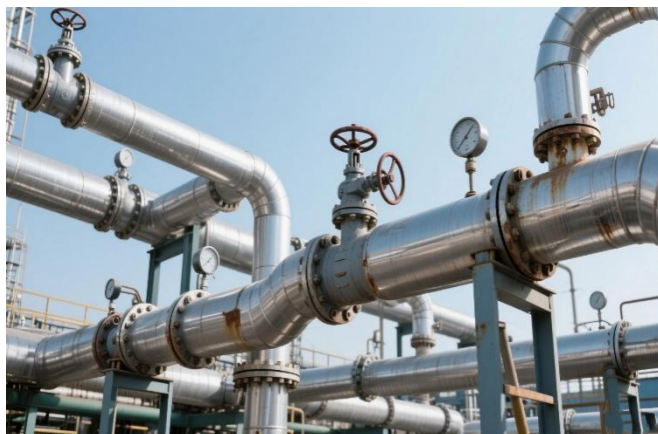
图 4：丙烯运输管道
